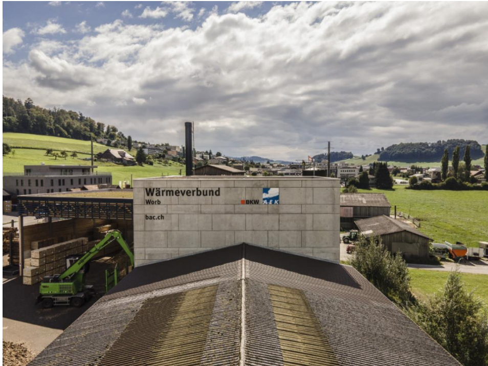
Die Heizzentrale des Wärmeverbundes Worb auf dem Areal der OLWO AG
