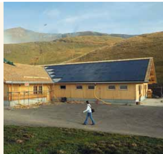
Das Dach der Rinderhütte eignet sich ideal zur Produktion von Sonnenstrom.
