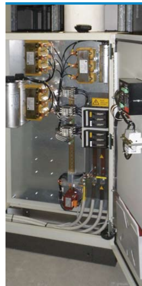
Die Motorfahrzeugkontrolle des Kantons Solothurn vermeidet Blindstrom. Im Mai 2008 installierte sie eine Kompensationsanlage.
